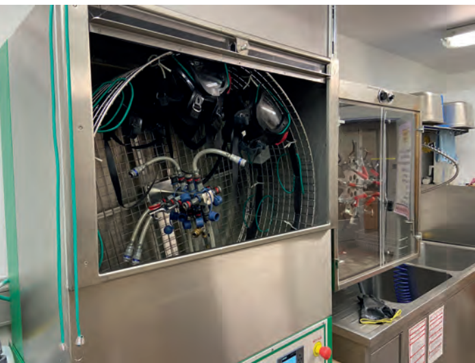
Desinfektionsbereich mit neuem Vollautomat
