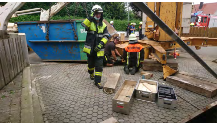
Kran droht zu fallen
