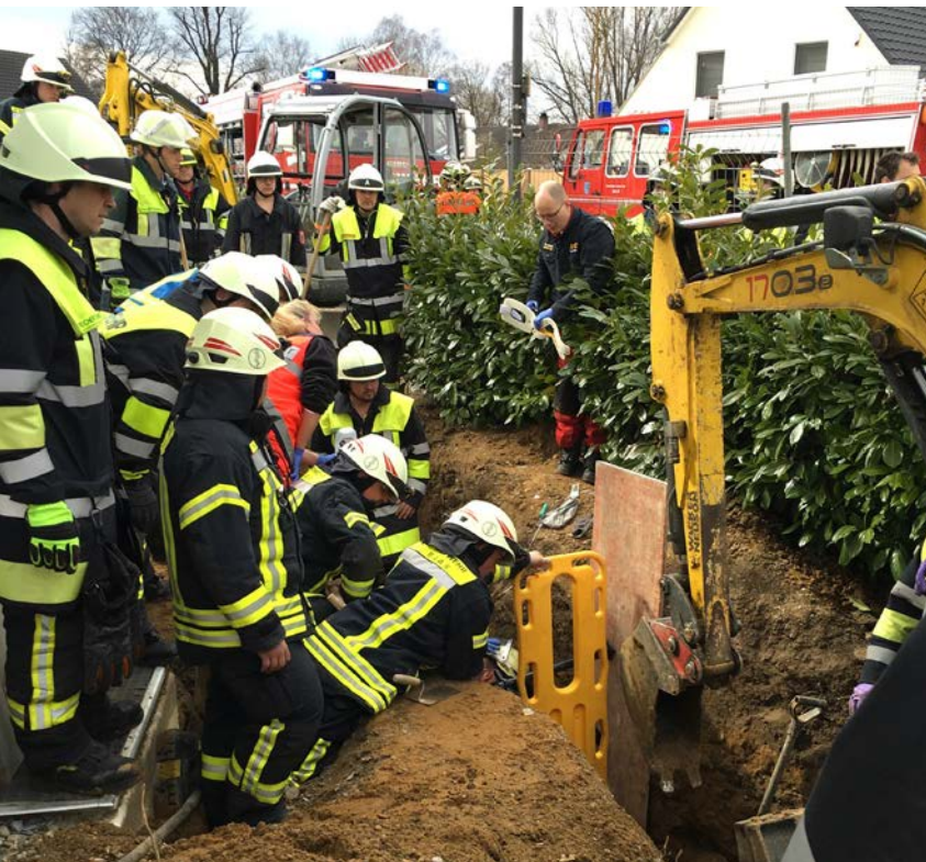
Bauarbeiter in Grube verschüttet
